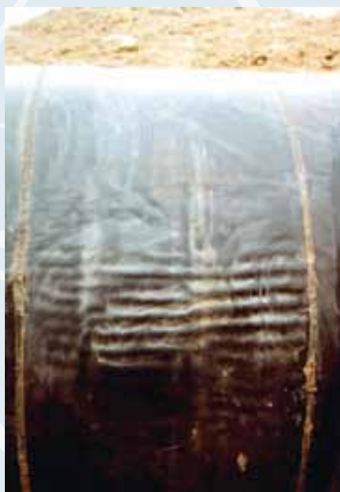
ABBILDUNG 6. Faltenbildung infolge von Beanspruchung und Erddlasten.
