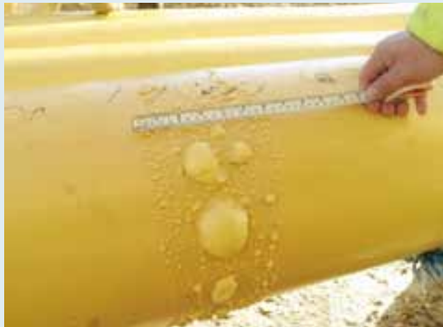
ABBILDUNG 3. Blasenbildung der Beschichtung während der Vorwärmung.
