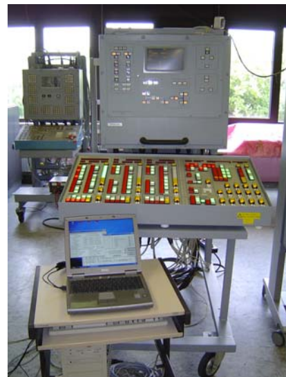
Zentraler Bedienplatz, Anteil Torpedo-Rohranlage (ToRA)
