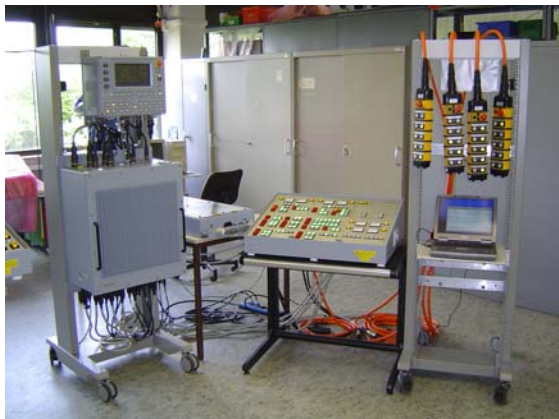
Zentraler Bedienplatz, Anteil Torpedo-Transport und Stau-einrichtung (ToTS)
