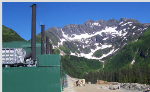
Die zur Abgasreinigung nötige Harnstoffwasserlösung wird in einer mobilen Anlage hergestellt.
