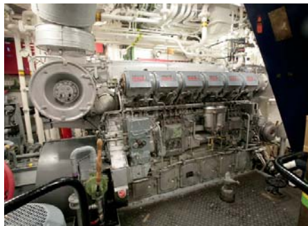
Blick auf die neue Antriebsmaschine
